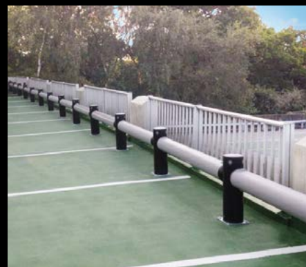
Zábрана iFlex Single Traffic Barrier vysoká tvoří obvodovou ochranu víceúrovňového parkoviště.
